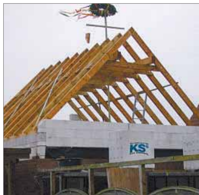
Nach dem Richtfest der Jugendwerkstatt fallen noch viele Arbeiten an. Alle Beteiligten freuen sich jetzt schon auf das Ergebnis ihrer Mithilfe. FOTO: GERKEN
